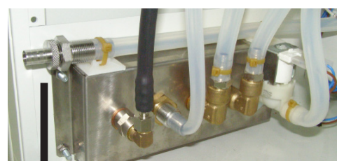
Válvula de vaciado del refrigerante
