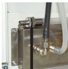
Válvula de vaciado del refrigerante
